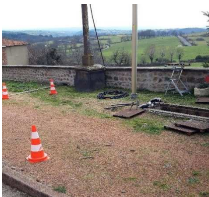
Chambre en domaine public. Lors des interventions, l'accès aux chambres doit être sécurisé par les techniciens.
